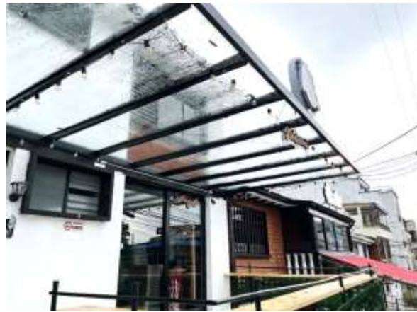
Foto No 2. En el área del antejardín, se construyó una cubierta en estructura de aluminio con vidrio.
