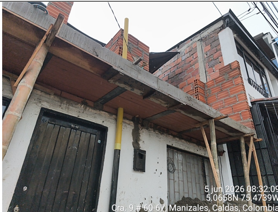
Imagen No. 5 – Losa de entepiso en voladizo. Fuente: Equipo Técnico de Vigilancia y Control Urbanístico.
