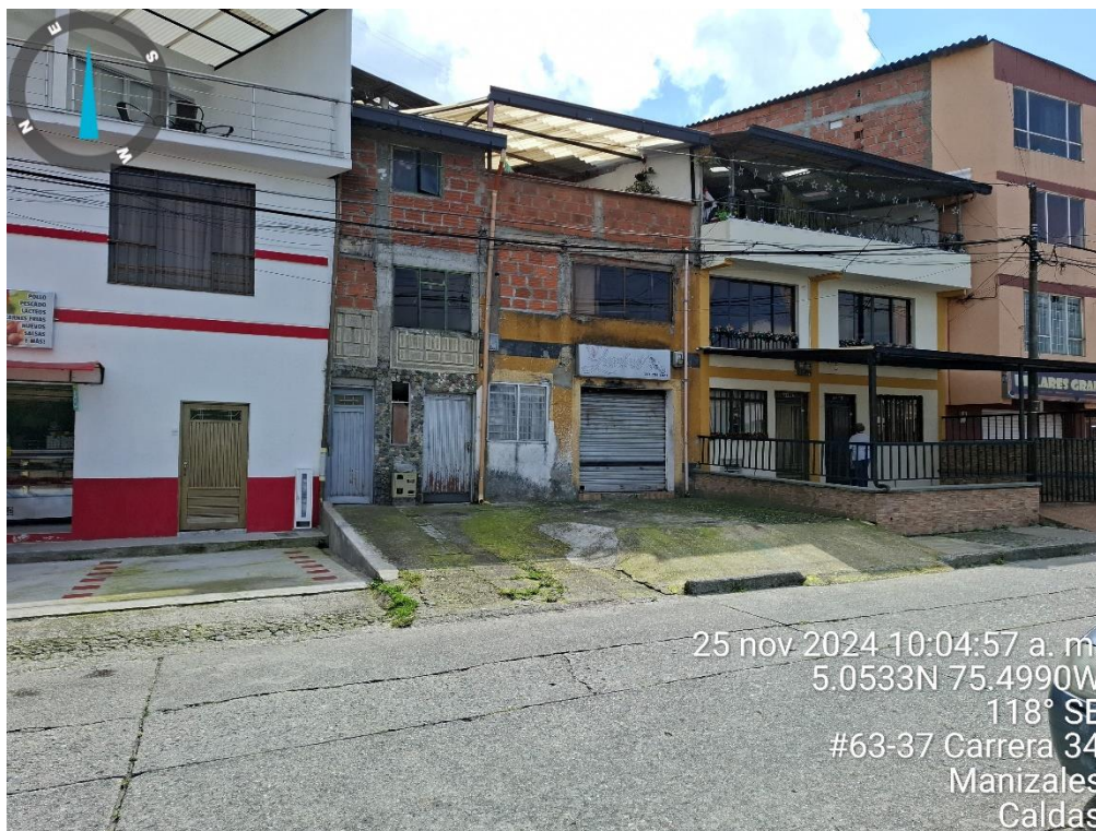
Imagen No. 1 – Evidencia fotográfica de visita técnica de inspección. Fuente: Equipo técnico de vigilancia y control urbanístico. Fecha: 25 de noviembre de 2024
