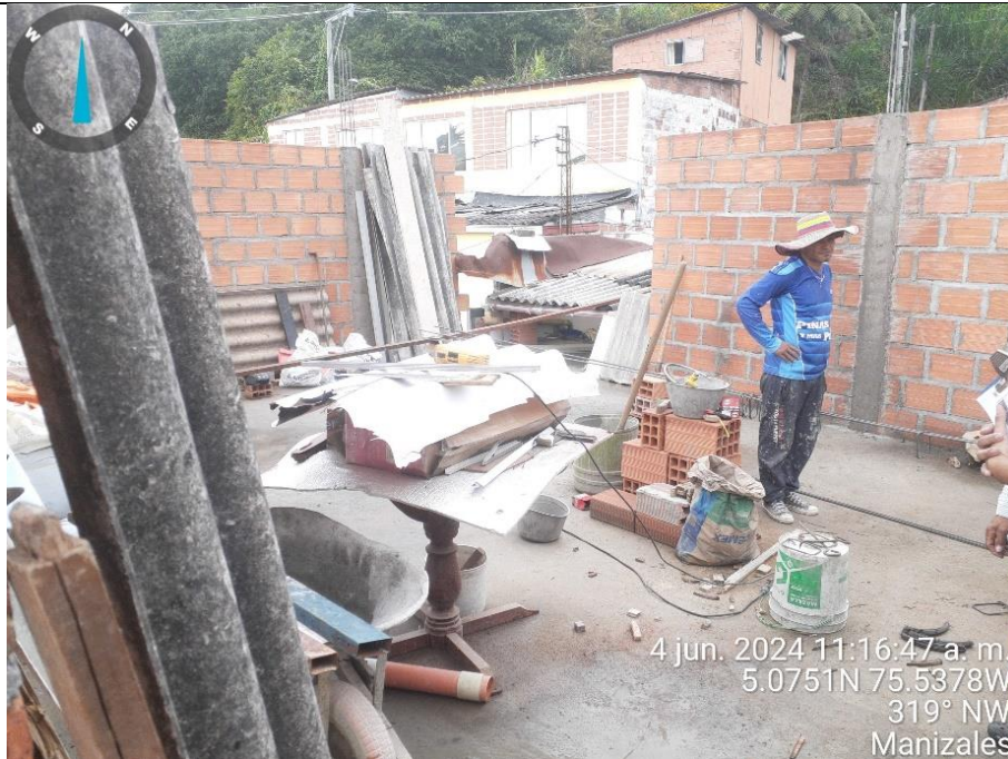
Imagen No. 5 – Evidencia fotográfica de labores constructivas en vivienda carrera 12 No. 1B-05.
