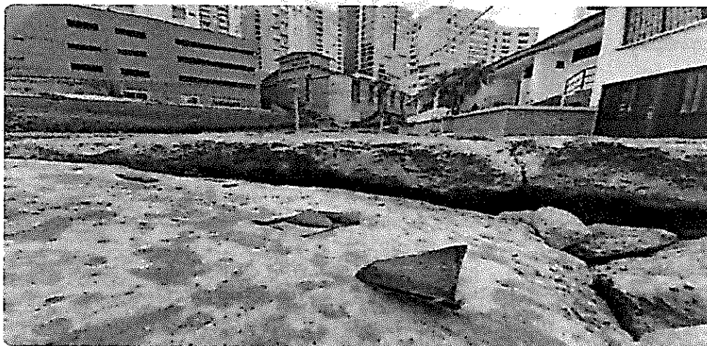
En La Rambla los habitantes han recurrido a escombros para evitar accidentes.
