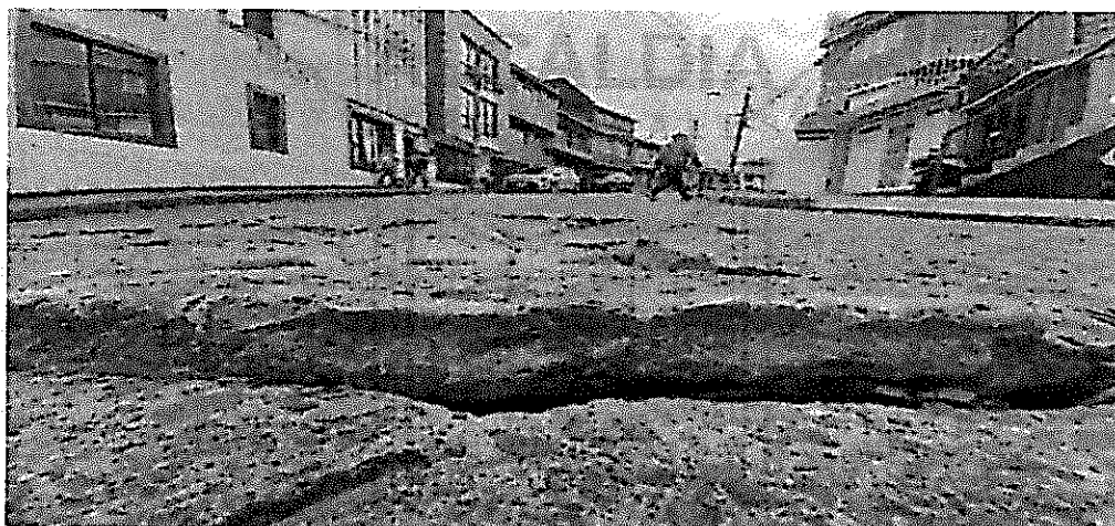
El roto de La Asunción le causó fractura de tabique a un ciclista.
