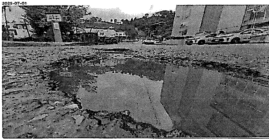
Daño en la calle 92, sobre la entrada a Oncólogos de Occidente
