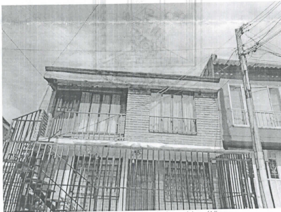
Foto No3. Trayecto del cableado de servicios públicos
