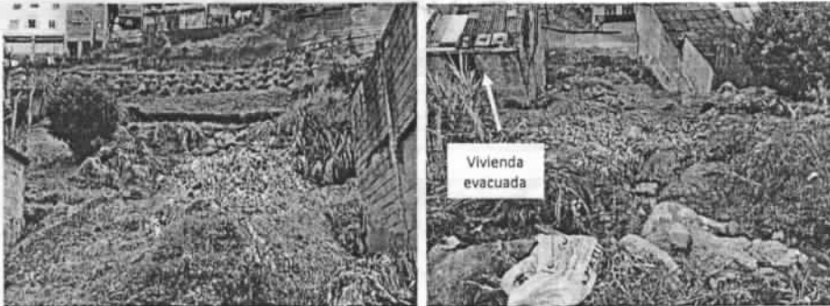
Imágenes 1 y 2. Deslizamiento
