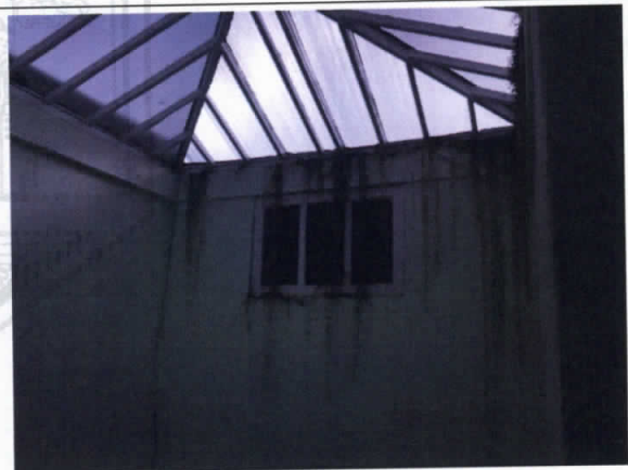
Foto No 34. Retirar vegetación de marquesina.
