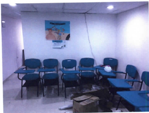
Foto No 5. Muros en buen estado. "Bayport".
