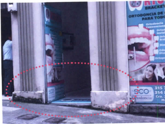
Foto No 1. Desprendimiento de pintura y hongos.
