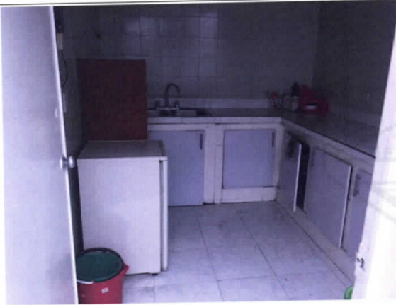
Foto No 37. Piso deteriorado de cocina.
