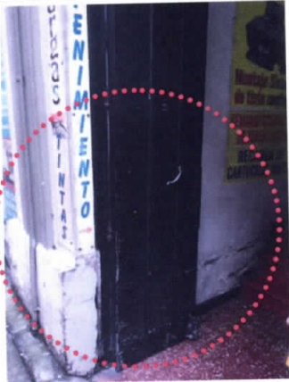
Foto No 7. Muros y puerta deteriorados. "Impre laser-cintas"
