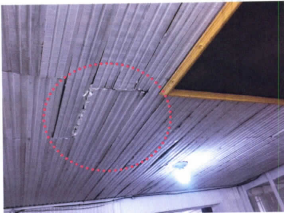
Foto No 15. Cielo raso deteriorado "Impre laser-cintas".
