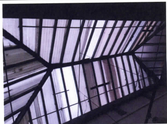
Foto No 34. Falta de mantenimiento en marquesina.
