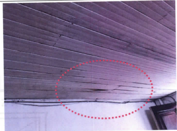
Foto No 14. Cielo raso deteriorado "Impre laser-cintas".
