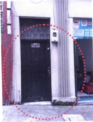
Foto No 3. Hongos y puerta deteriorada.
