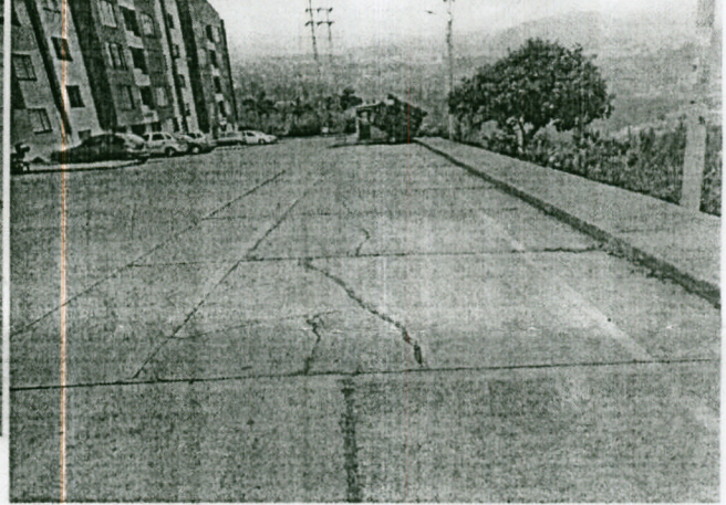
Agrietamiento longitudinal zona de parqueadero.
