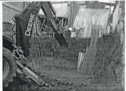
Foto No. 2 Excavaciones sin licencia aprobada
