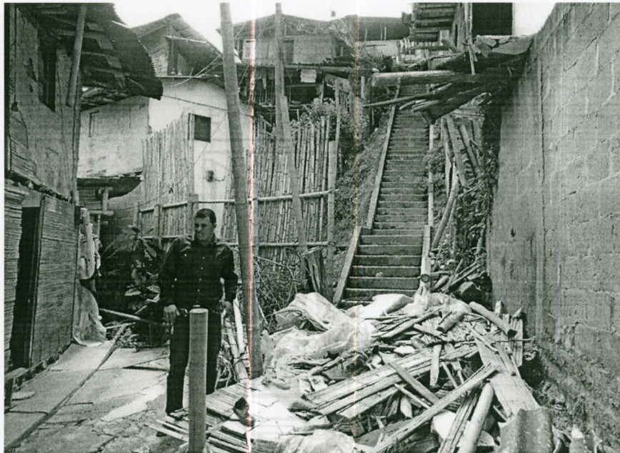
Imagen 2. Colapso de la vivienda
