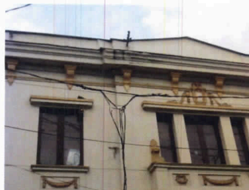
Fotografía 2. Humedades en el alero
