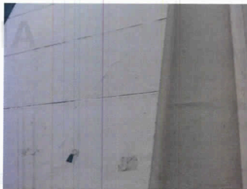
Fotografía 4. Fisuras sobre la fachada interior del inmueble
