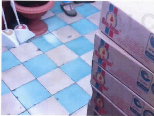
Fotografía 17. Pisos de Cerámica en regular estado
