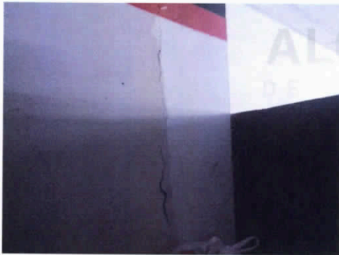
Fotografía 7. Fisuras en el local
