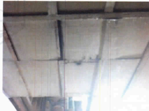
Fotografía 20. Cielo raso en madera con desprendimiento de material
