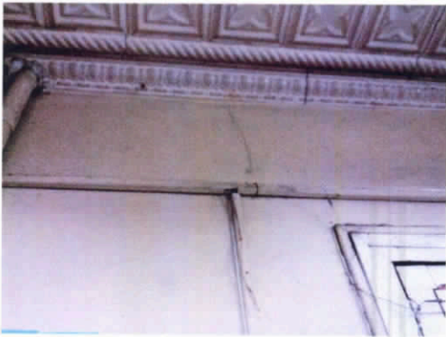
Fotografía 27. Fisuras en Muros
