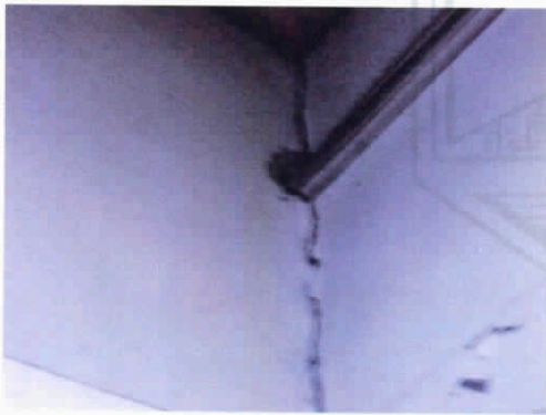
Fotografía 23. Fisuras en Muros
