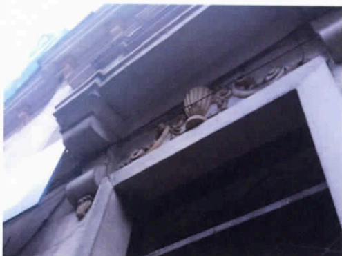
Fotografía 1. Fisuras sobre la fachada
