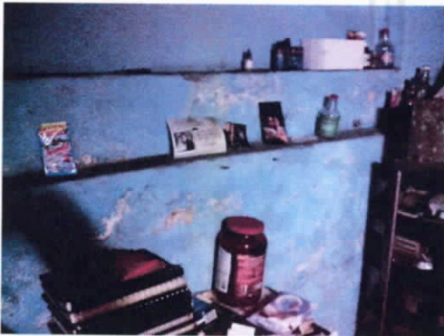
Fotografía 9. Humedades en el local
