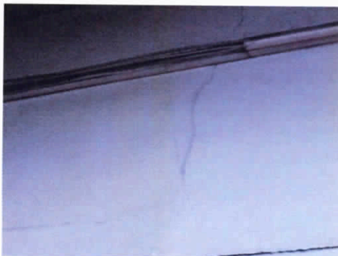
Fotografía 25. Fisuras en Muros
