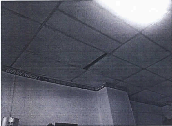
CIELO RASO QUE PRESENTA ELEMENTOS SUELTOS, EN REGULAR ESTADO. LOCAL ACADEMIA DE BILLARES Y FUENTE DE SODA MANHATTAN.
