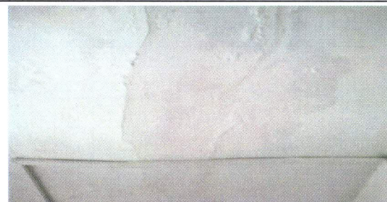
FOTO No. 14 HUMEDADES EN ALGUNOS APARTAMENTOS
