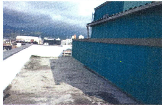
FOTO No. 12 TERRAZA EN BUEN ESTADO
