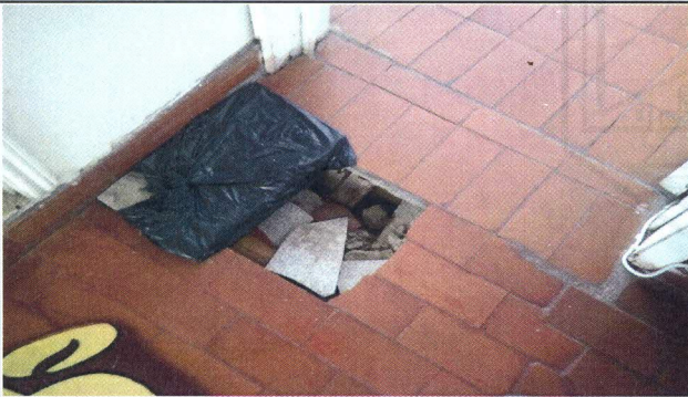
FOTO No. 17 HUECO EN UNA PLACA EN CONCRETO
