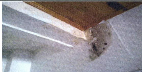
FOTO No.13 HUMEDADES EN ALGUNOS APARTAMENTOS
