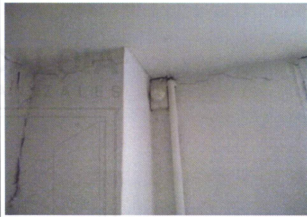
FOTO No. 16 FISURAS EN APARTAMENTO
