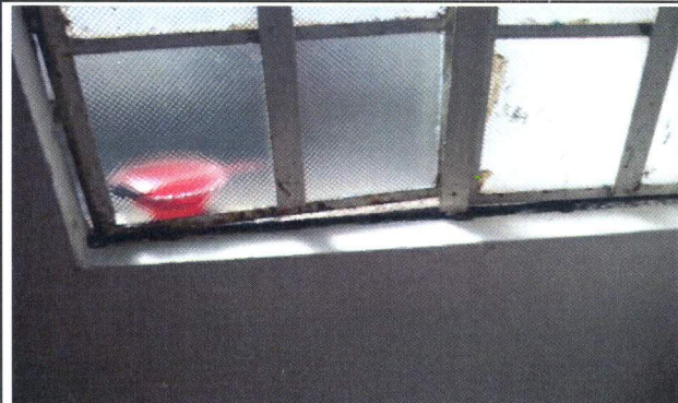
FOTO No. 20 MARCOS DE VENTANAS CORROIDAS
