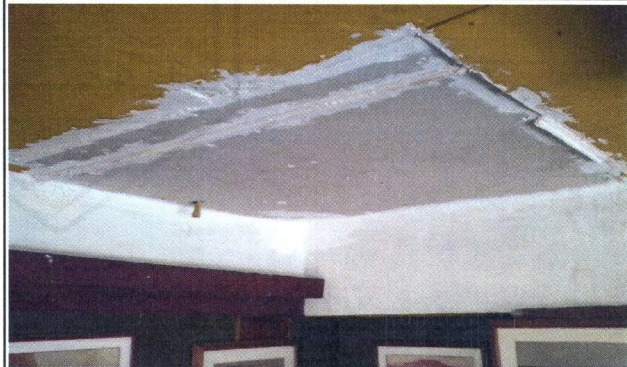
FOTO No. 12 CIELO RASO - NO ESTÁ UNIFORME
