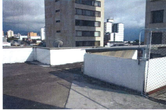
FOTO No.10 CUBIERTA VACIO EN TEJA PLASTICA
