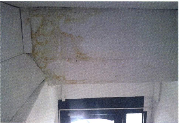
FOTO No. 13 HUMEDADES EN CIELO RASO
