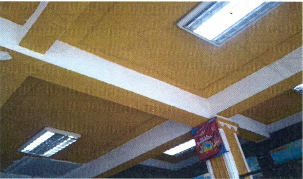
FOTO No. 11 CIELO RASO - PINTURA SOPLADA HUMEDAD
