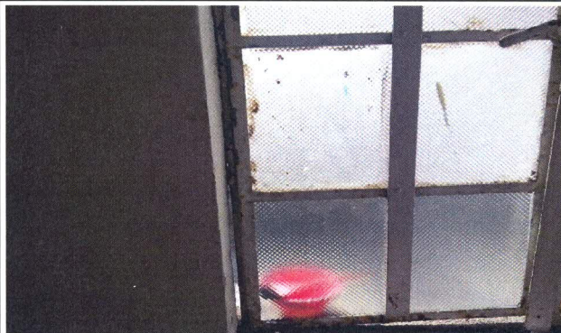
FOTO No. 19 MARCOS DE VENTANAS CORROIDAS
