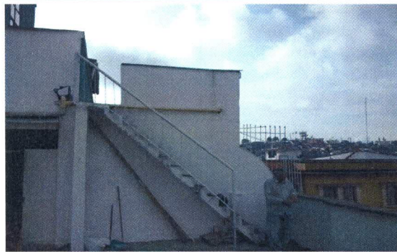
FOTO No.11 TERRAZA EN BUEN ESTADO
