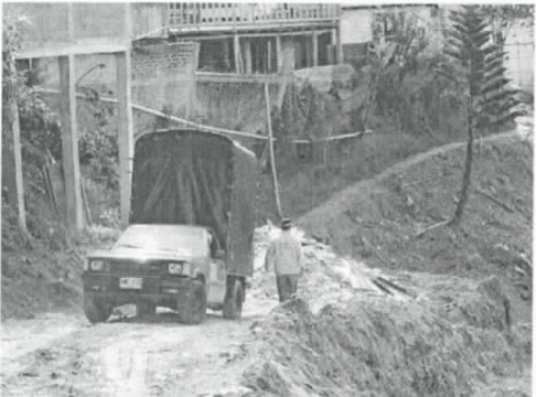
Foto No. 3 Vertimiento de escombros
