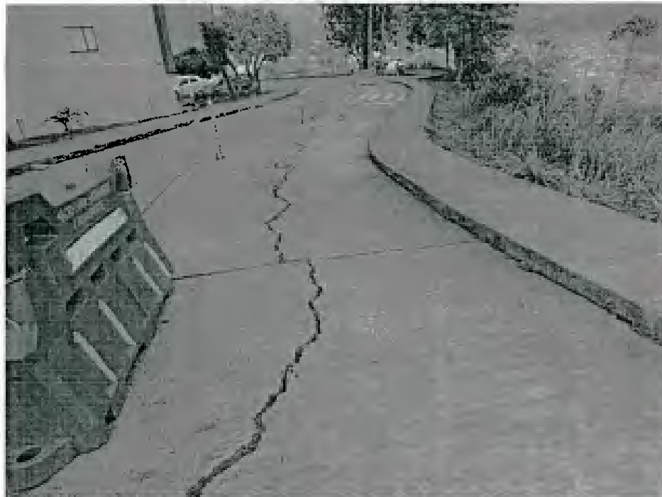
Agrietamiento tipo falla de borde- sector sur-occidental (caso 3).
