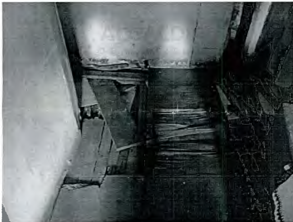
Imagen 4. Entre piso de la vivienda en alto grado de deterioro.
