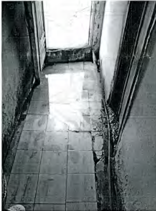
Imagen 2. Humedades en la entrada de la vivienda.
